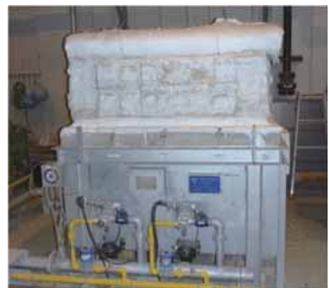
●耐火試験装置 (炉内面積900×900mm、最高温度1350℃)
