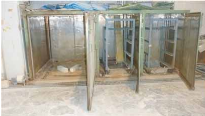
●蒸気養生装置
