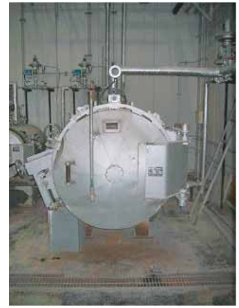
●オートクレーブ養生装置
